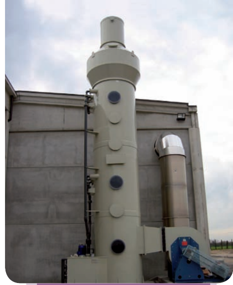
Torre de lavado (scrubber) instalada en una depuradora de aguas residuales.
