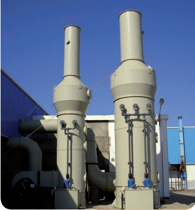
Sistema de tratamiento de gases (scrubber) en una planta química.
